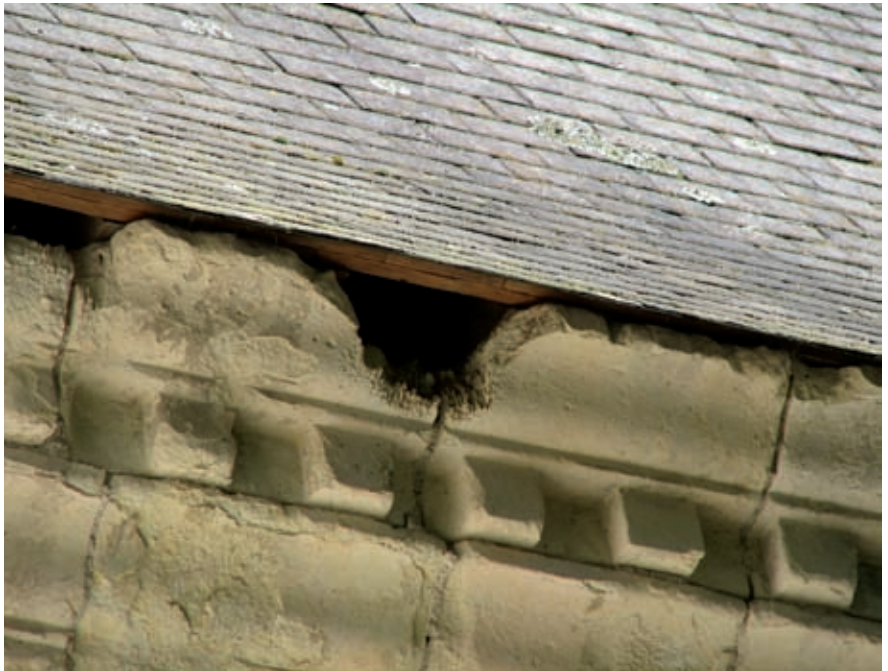
Openingen naar dakconstructies worden al te vaak weggerestaureerd
