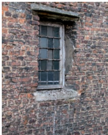
Duivenmest dringt in de poreuze bakstenen
